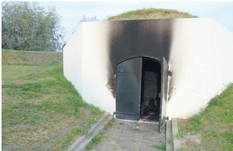
De schade als gevolg van de acties van vandalen
